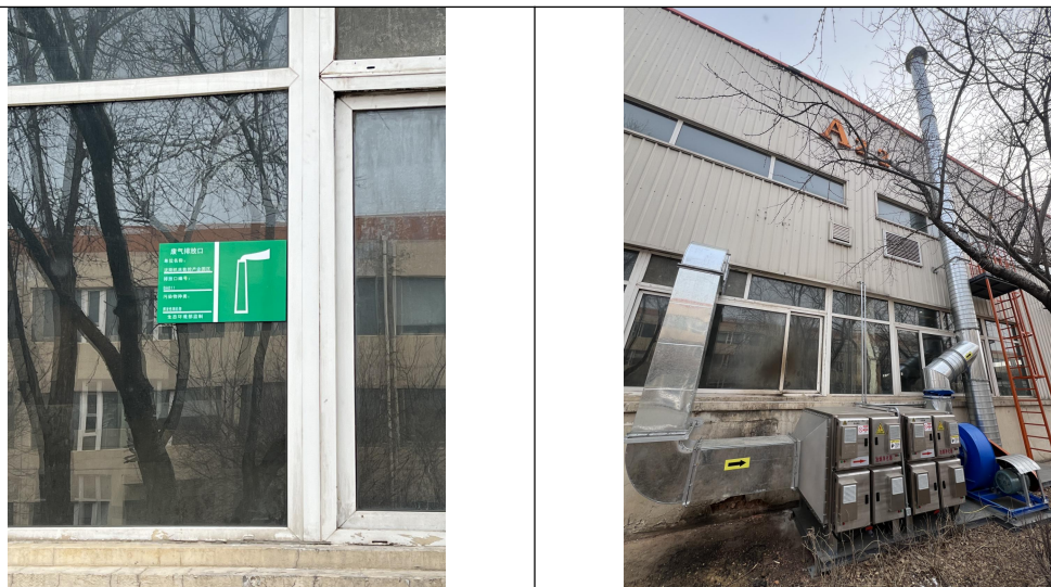
DA011 废气排放口
