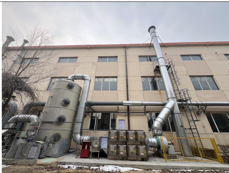
DA002 废气排放口
